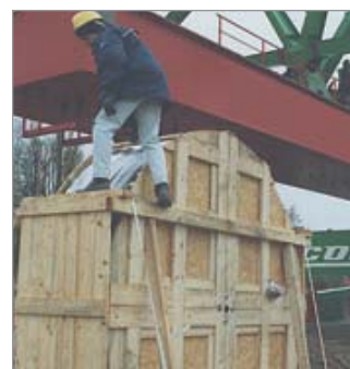
■ Montagem para transporte de sistema completo de Esteira Porta Cabos e cabos
